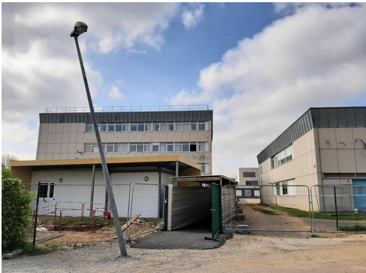
Il faut encore détruire l'ancien collège et créer une desserte. Ces travaux devraient commencer dans les jours qui viennent. ©Le Courrier de l'Eure / MC
